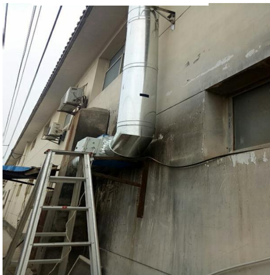
油烟净化设施图片
